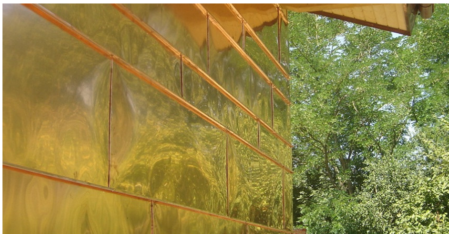
Bodega en Villa Verde de Trucios, Vizcaya. Fachada de junta alzada horizontal
